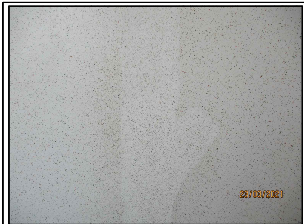
27 지상2층 벽체 수직 균열
