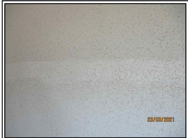
38 지상4층 벽체 수평균열
