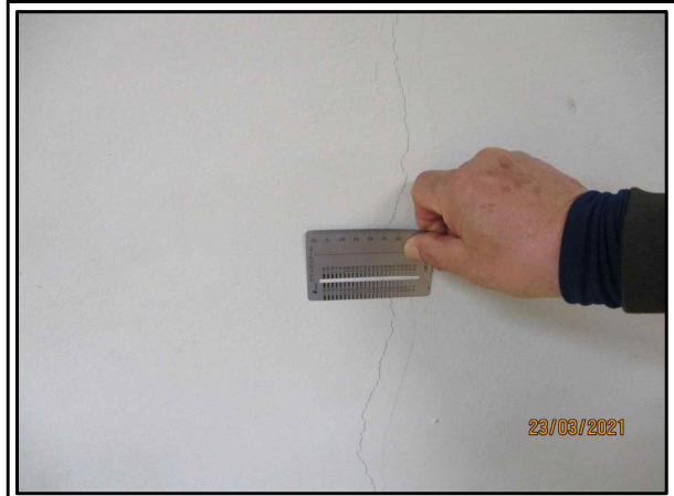
8 지하1층 벽체 수직균열
