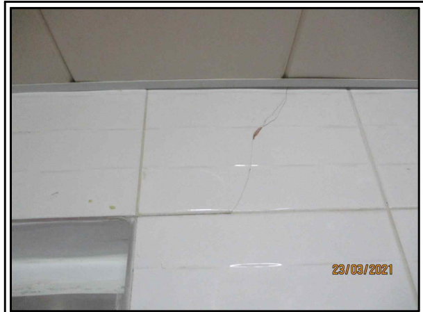
44 지상4층 벽체 타일균열
