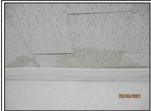
37 지상4층 E.J천장 마감재 누수흔적
