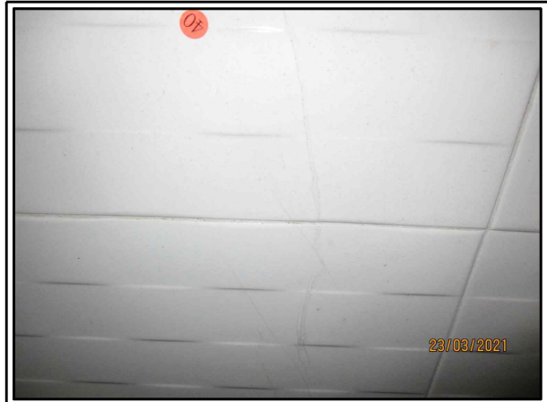
10 지하1층 벽 타일 균열
