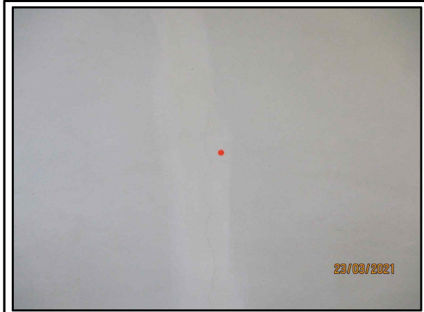
7 지하1층 벽체 경사균열
