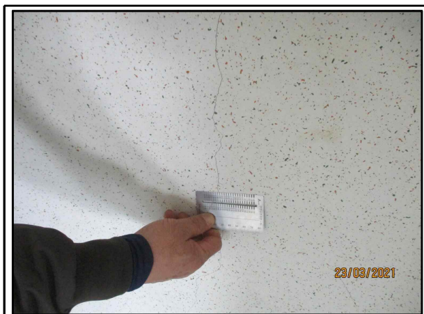
45 지상4층 벽체 수직균열
