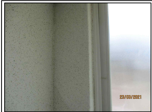
25 지상2층 벽체 수직 균열
