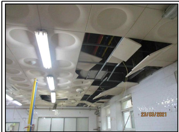
11 지하1층 천정 마감재 파손
