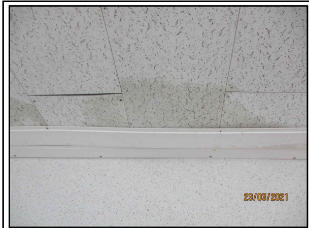
43 지상4층 상부 슬래브 접합부 부위 누수흔적
