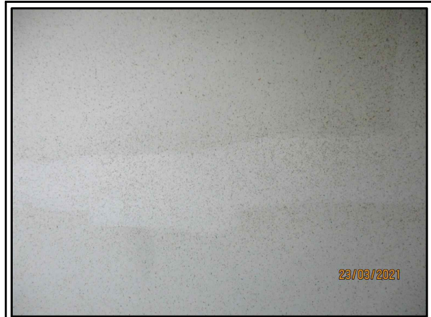
26 지상2층 벽체 수평균열
