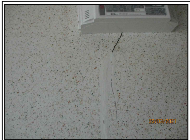
12 지하1층 벽체 수직균열
