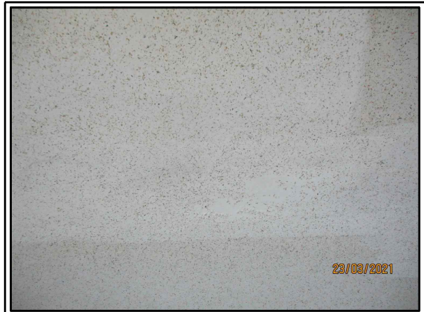
40 지상4층 벽체 누수흔적 및 도장박리
