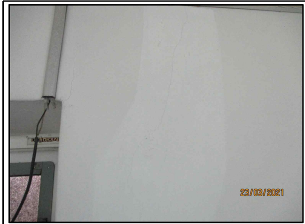
9 지하1층 벽체 수직균열
