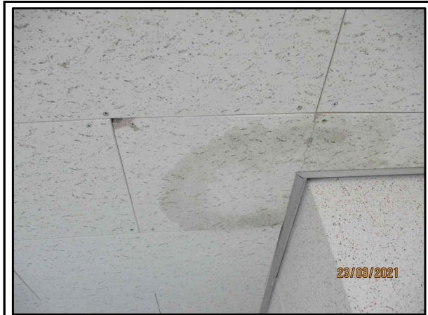
31 지상3층 천정 마감재 누수흔적
