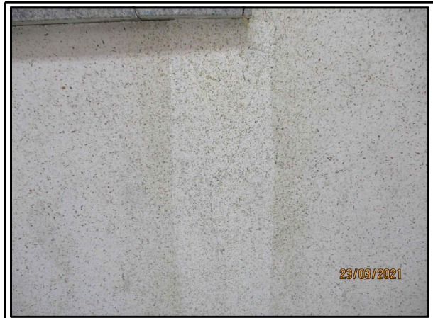
16 지상1층 벽체 수직균열
