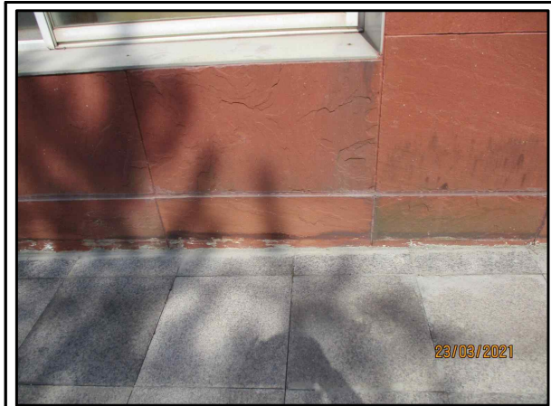
19 지상1층 바닥 접합부 이격
