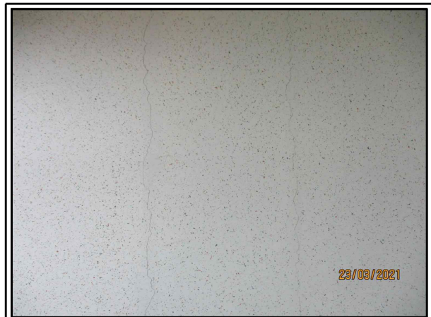
28 지상2층 벽체 수직균열
