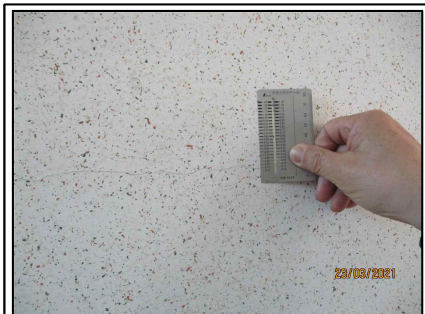
35 지상3층 벽체 수평 균열
