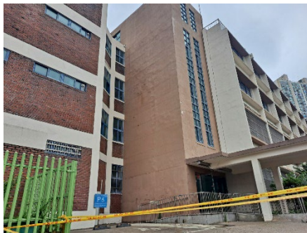
후관동 드라이비트 외단열 현황 (추가탈락 위험 부분)
