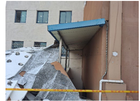
본관동 드라이비트 외단열 탈락 당시
