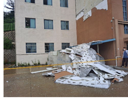
본관동 드라이비트 외단열 탈락 당시
