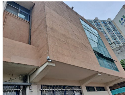
후관동 드라이비트 외단열 현황
