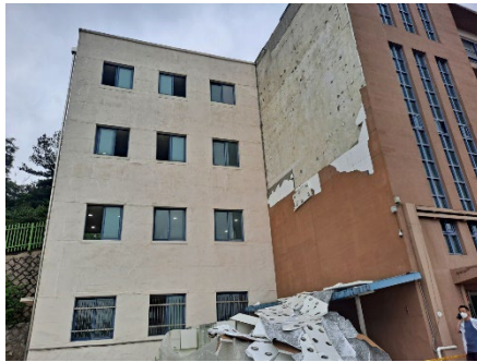
본관동 드라이비트 외단열 탈락 당시
