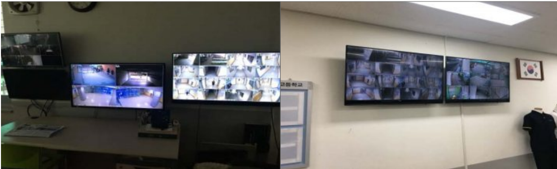
실내 모니터 설치
