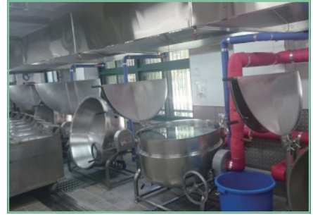
안전을 고려한 스팀배관 보호시설
