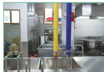
관리가 용이한 천장 배관 급수시설
